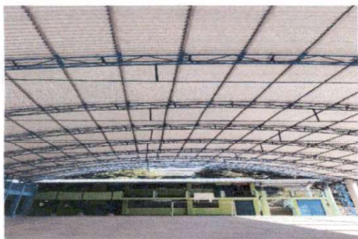
Foto 3: Cambio de estructura de soporte de metal, por metal en el patio del establecimiento.
